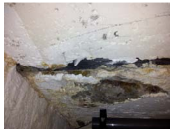
Nok å ta tak i i Askøyhallen. Bildet viser lekkasje fra bassenget og ned i teknisk rom.
